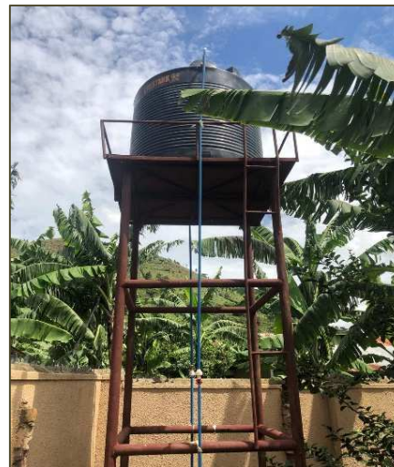
Bild: Wassertank bei der Station
